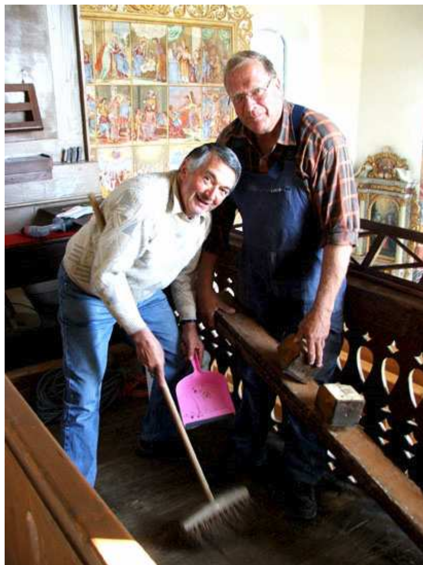
Fleißige Hände waren am Werk, um Platz zu schaffen für die "neue Orgel". Die alte Orgel und die Bänke auf der Empore mußten beseitigt werden.
