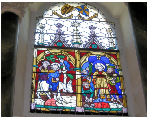
In der südlichen Kapelle der Pfarrkirche wurden im August 2019 die Glasfenster restauriert.
