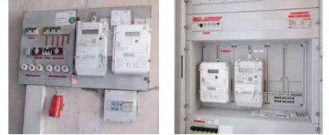
Elektro-Verteiler: Alt und dann Neu
